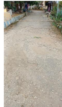
Gambar 1 Kondisi PSU jalan di Perumahan Mutiara Harum Desa Kalimook
