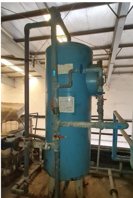
Gambar 5 Gambar Water softener dengan valve manual
