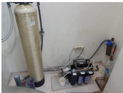
Gambar 1 Instalasi Pre Filter, RO dan Demin
