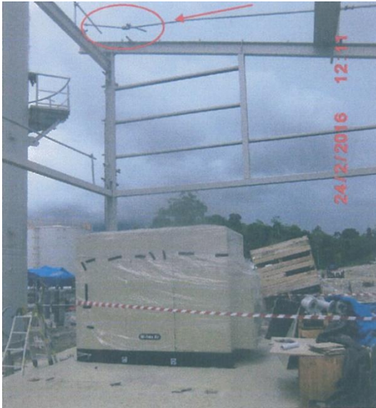
Gambar 6. Life Line dari Scaffolding di Nitrogen Shelter yang Terkena Benturan Dari Air Compressor B (373-V-1001B)
