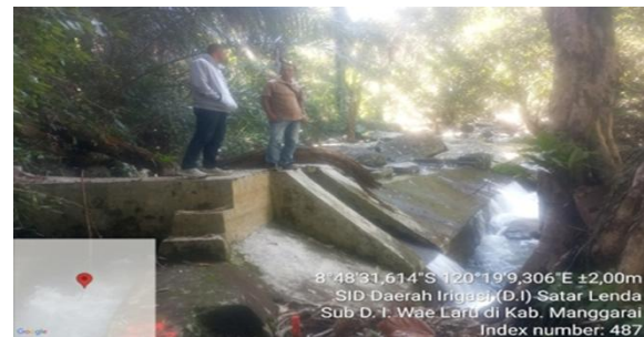
Gambar 2. Kondisi Tubuh Bendung dan Kolam Olak
