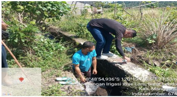
Gambar 4. Dinding Sekunder Baik, Lantai Tergerus, Dilubangi Akibatnya Bocor 2 Sisi
