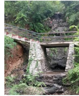
Gambar 4. Fase Awal Potensi Rill Erosion pada Area Lereng Jembatan Liliba (2025)
