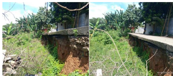
Gambar 3. Dokumentasi area longsoran
