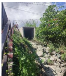
Gambar 3. Kondisi Outlet Drainase Jembatan Kembar Liliba
