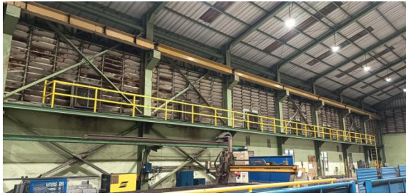
Gambar 2. Exhaust Fan Terpasang
