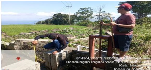
Gambar 5. Pintu Air Pintu Pembagi Tidak Ada
