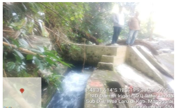
Gambar 3. Pintu Pembilas & Intake Tidak Ada
